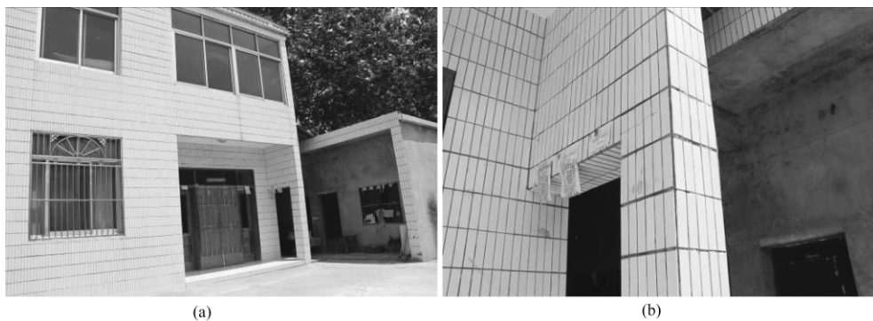
图4 夏集镇双砦村苏南组一砖混结构楼房轻微受损
