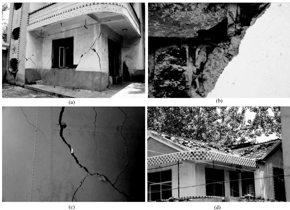
图3 夏集镇双砦村苏南组一砖混结构楼房严重受损
