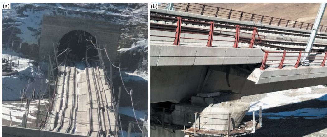
图8 硫磺沟大桥桥面变形(a)与位错(b)照片
