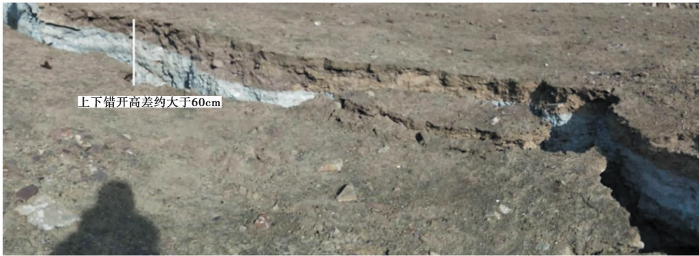
图 7 地表破裂照片
